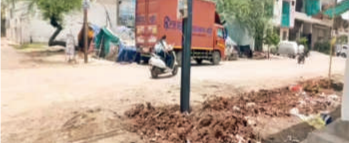
पाइपलाइन के ऊपर ही बिजली का पोल लगा दिया। इससे इलाके के 3500 से ज्यादा घर पानी के लिए तरस गए क्योंकि
