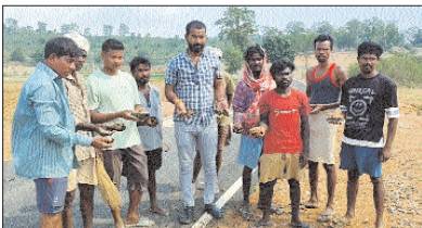
राजपुर (अम्बिकावाणी समाचार)। के पहाड़ी कोरवा बस्ती में लगभग डेढ़ करोड़ रूपए की लागत से सड़क का निर्माण किया गया है। लगभग १ महीने पहले ही सड़क बनी है लेकिन इसमें इतनी घटिया मटेरियल का इस्तेमाल किया गया है कि सड़क एक महीने में ही उखड़ने लगी है और लोग अपने हाथों में सड़क लेकर घूम रहे हैं। ग्रामीणों ने बताया कि इससे पहले उनके गांव में कभी पक्की सड़क नहीं बनी थी लेकिन पहली बार जब पक्की सड़क का निर्माण हुआ
